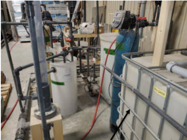
Eaux Grises dans le bac d'alimentation
